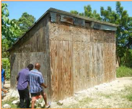
T-Shelter Croix-Rouge Allemagne à Léogâne, 2013 - Dégradation importante des panneaux de plywood, insalubrité du logement
