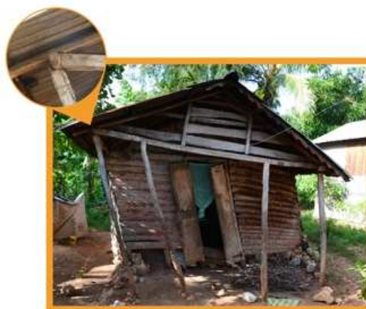
Maison en structure bois ayant subi le séisme de 2010 (Jacmel). La structure s'est déformée, mais ne s'est pas rompue
